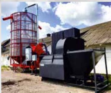
Зерносушарка Pedrotti Large 270 та теплогенератор ТПК 15
