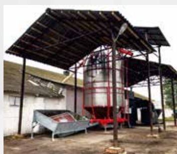
Зерносушарка Pedrotti Large 270 та теплогенератор ТПК 15
