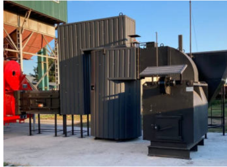
ТеплоФарм 15, зерносушарка Pedrotti Large 270, Кіровоградська область
